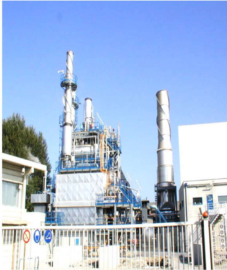
Centrale co-génération de SETHELEC (Arlès), Filiale ELYO
